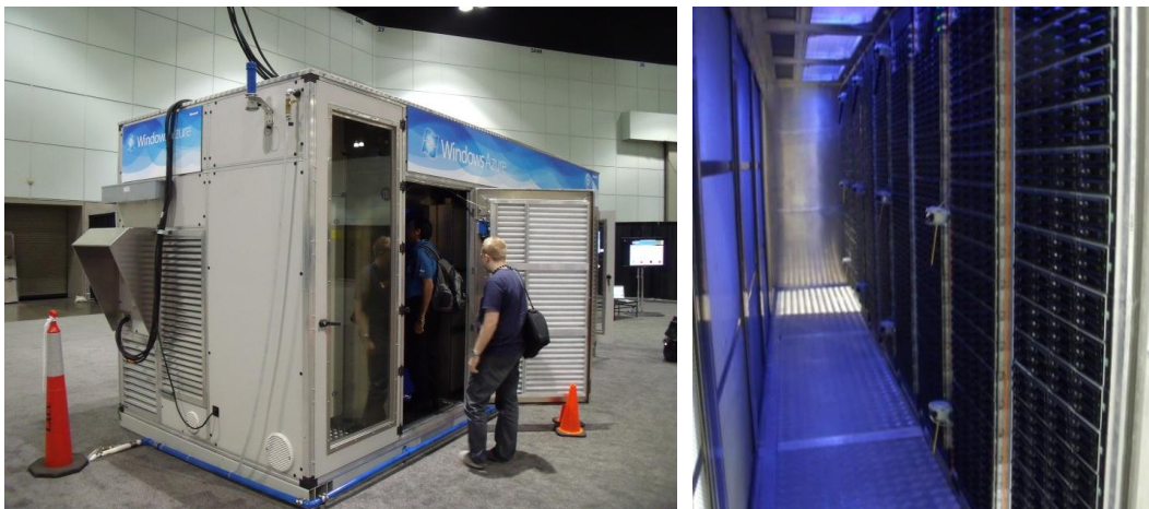
Abbildung 1: Ein Container mit ca. 2500 Servern für Cloud Computing am Beispiel von Microsoft Windows Azure [Lyl09]
